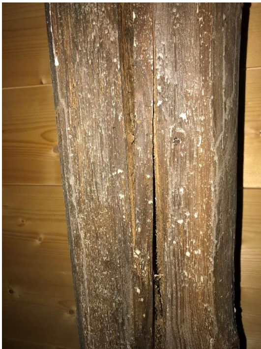
Abbildung 3: Mit Cyclodextrin behandelter historischer Dachbalken (Bildquelle: Pamela Jentner)
