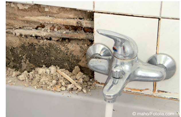
Undichte Fugen führen zu verdeckten Schäden
