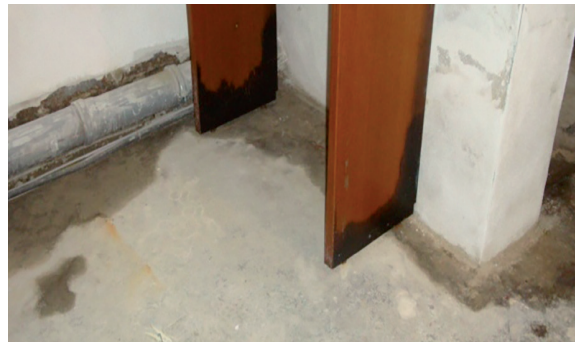
Aufsteigende Feuchtigkeit durch fehlende oder defekte Vertikal- / Horizontalsperren
